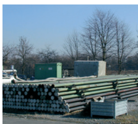
Mobile Leitung DN 100 DP 100 Rund 3,6 km
